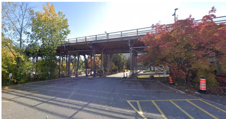
Figure 6 : Conditions existantes sous le pont du côté de Gatineau
