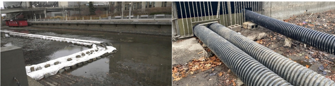
Figure 5-2 : La nouvelle installation de drainage près du pont Laurier. Photo de gauche tirée de Larocque et Pringle (2020). La photo de droite est reproduite avec l'autorisation de la CCN.
