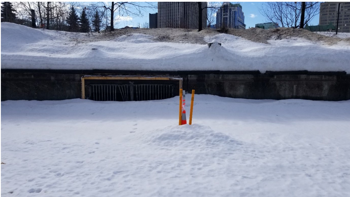
Photo 4.2 Installation d'une jauge au PK 0,3 (sortie du drain de l'avenue Laurier)
