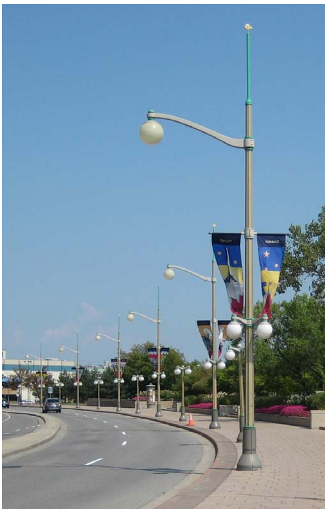
Éclairage de rue
