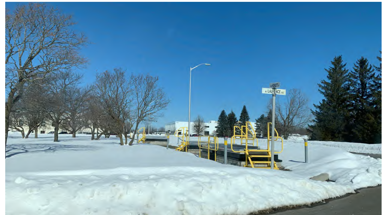
FIGURE 122. PHOTO DES TRAPPES D'ACCÈS AVEC ESCALIERS ET GARDE-CORPS DU COULOIR DE L'ÉNERGIE Source: Stantec
