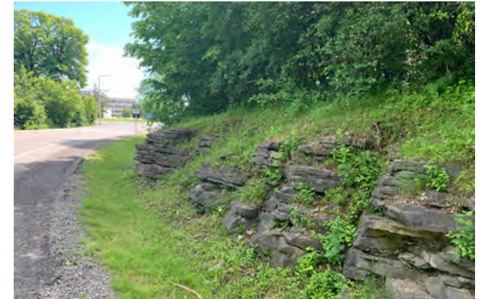
FIGURE 28. ROCHE MÈRE EXPOSÉE SUR LA PROMENADE LATHE DANS UNE VUE ENCADRÉE Source : Stantec
