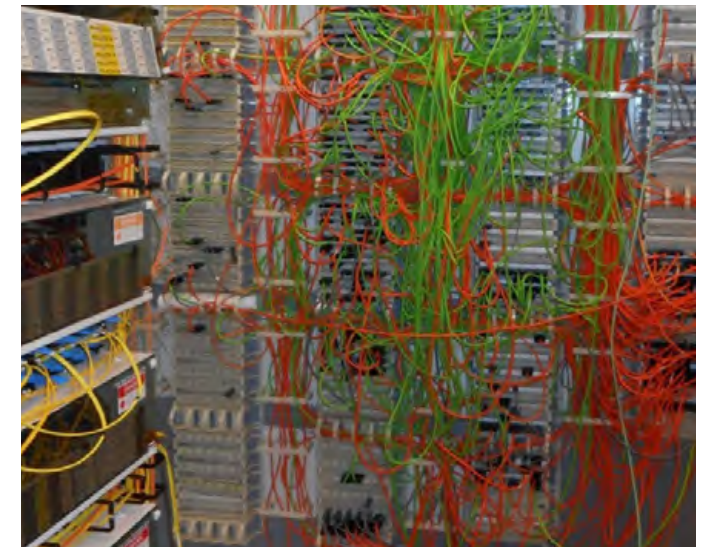
FIGURE 64. SALLE DES SERVEURS, SYSTÈME DE CÂBLAGE STRUCTURÉ Source : Stantec
